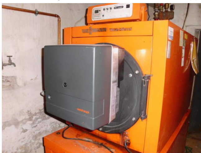
Abbildung 5-7: Die Heizanlage im Alten Schulhaus Marienstein.
